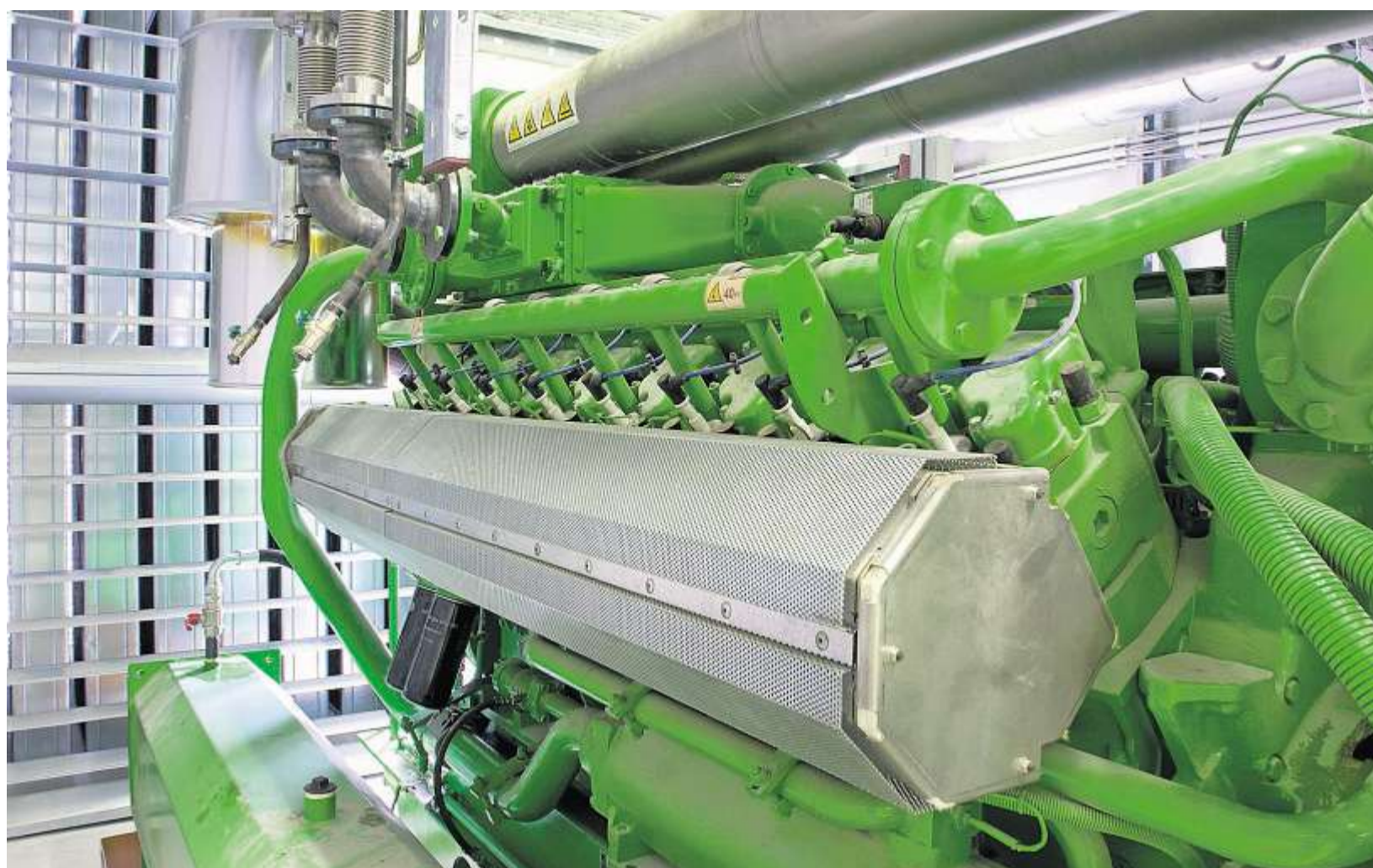
Seit 2008 ist das Biogas-Blockheizkraftwerk Walhalla Kalk in Betrieb und liefert pro Jahr insgesamt 5,25 Millionen Kilowattstunden Strom. Das Bio-Rohgas für den Betrieb wird in einer Anlage vor Ort produziert.
