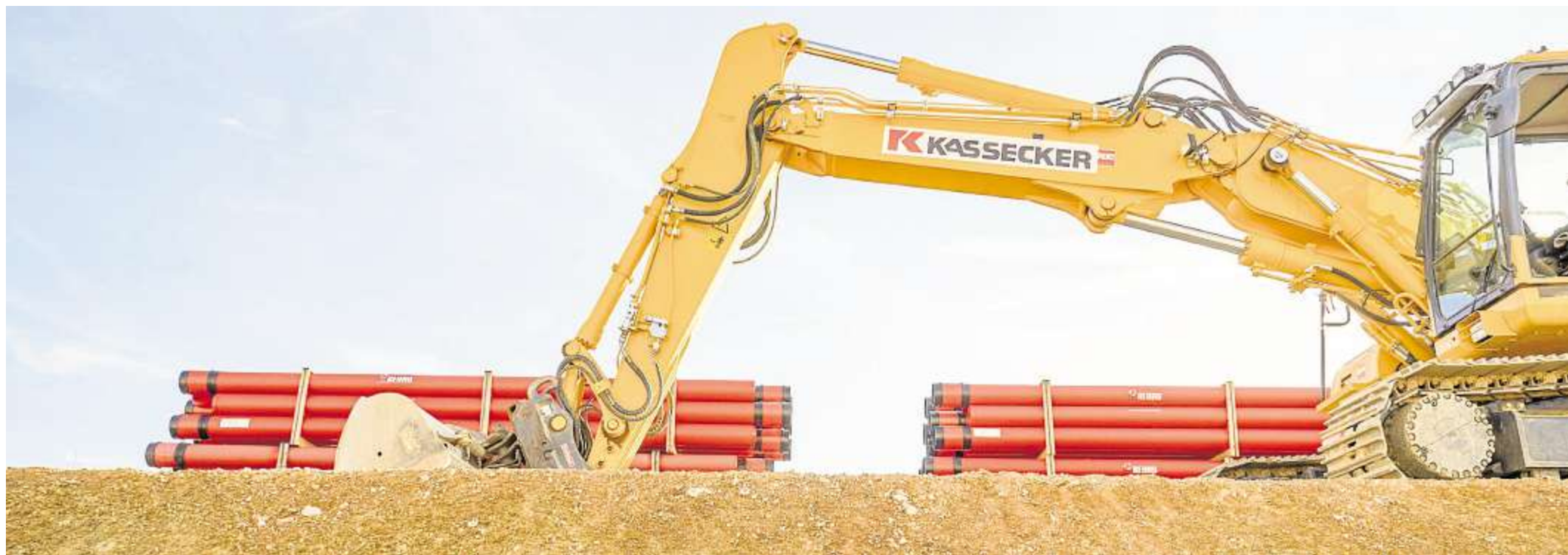
Aktuell ist der Netzausbau eine der wichtigsten Aufgaben für das Gelingen der Energiewende.
